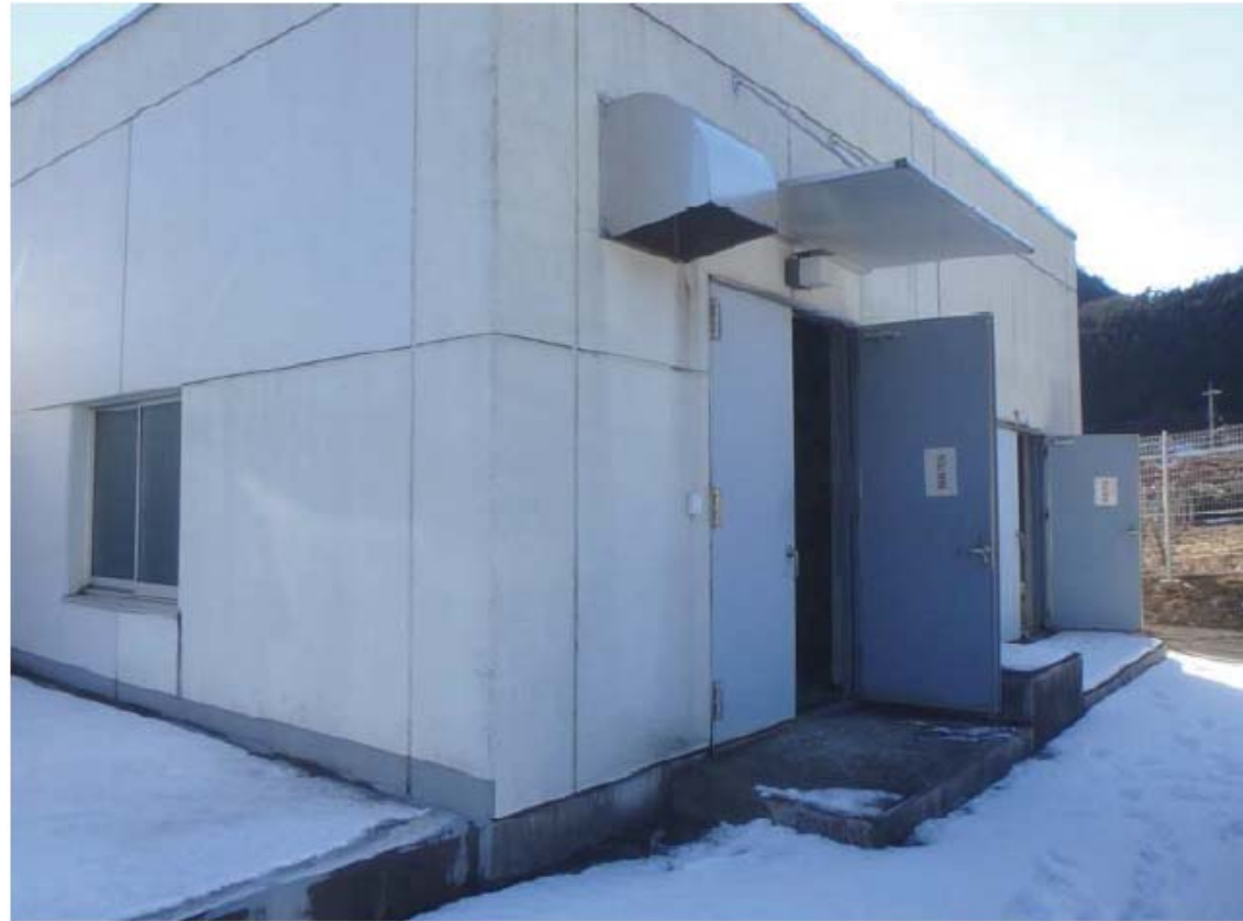
写真 1 第一減圧施設外観
